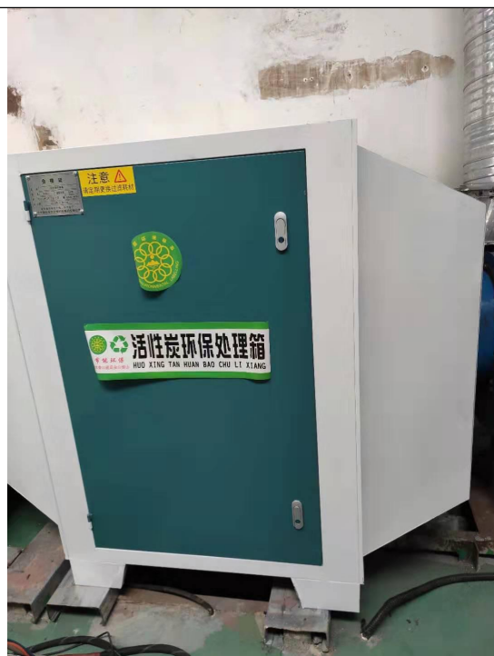
活性炭环保处理设备（固化工序）
