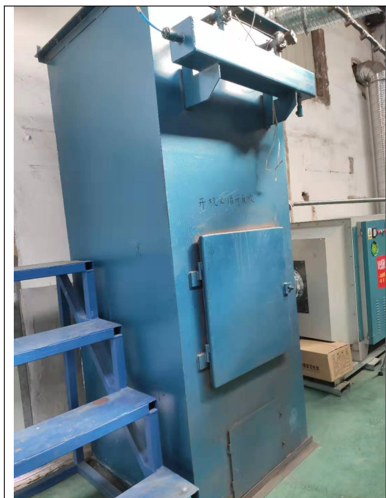
滤筒除尘器（抛丸工序）
