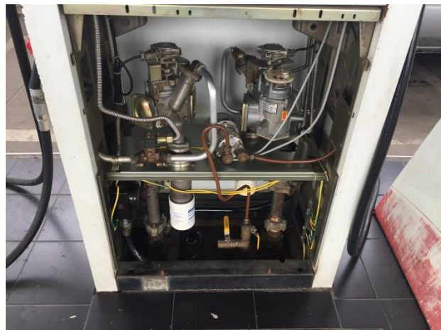
加油油气回收装置
