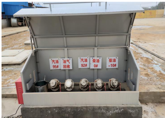
卸油油气回收装置
